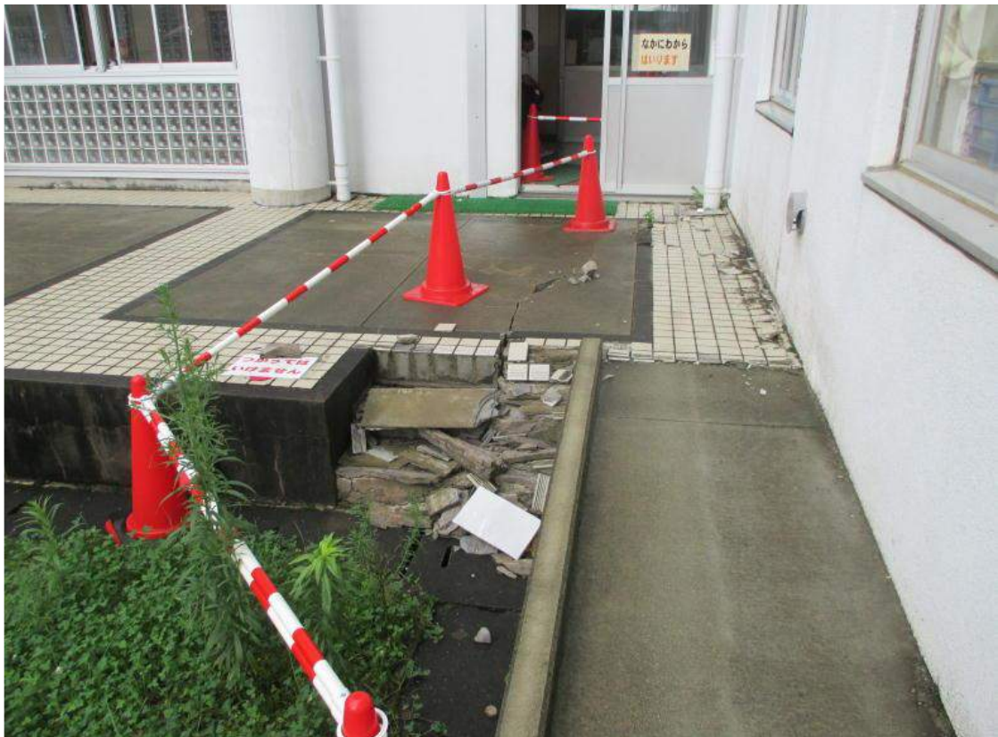
中庭出入口 損壊 利用禁止
