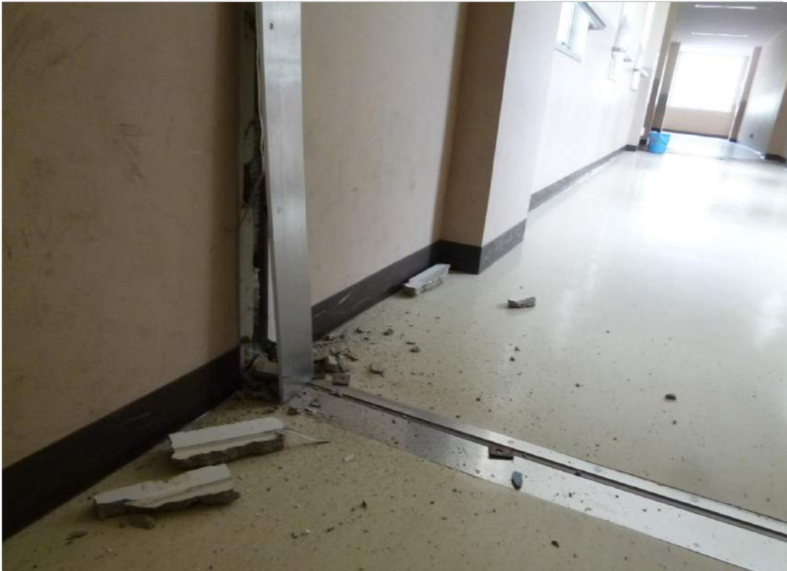
↑ 西側渡り廊下つなぎ目
