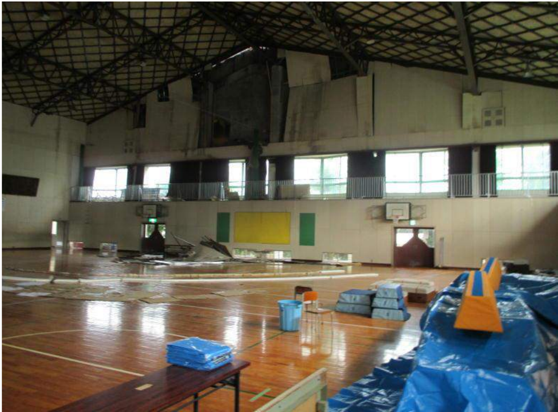
体育館 壁面崩落 使用禁止
